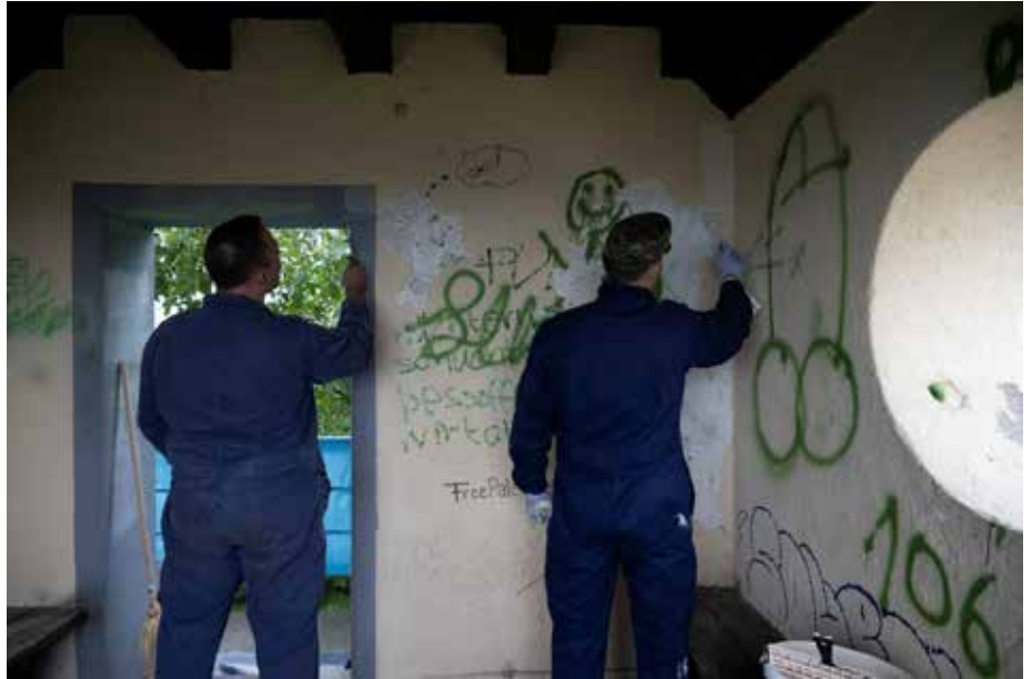
Die Stabskompanie des Versorgungsbataillons der Deutsch-Französischen Brigade nahm sich am diesjährigen Tag der Werte die Schmierereien am Jägerdenkmal im Gewann Luginsland vor.
